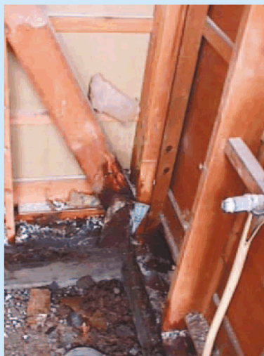
解体後の浴室内。蟻害と腐朽の状況がわかる。
